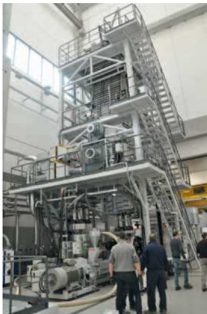
Dato che gli impianti sono piuttosto omogenei, A.S.I.S. ha potuto ottimizzare la progettazione ricorrendo a dei moduli master
